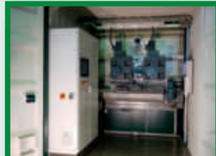
Technikraum: Alle wichtigen Komponenten erreichbar
