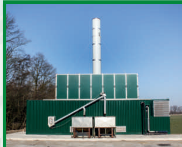
MCT 7 in Containerbauweise
